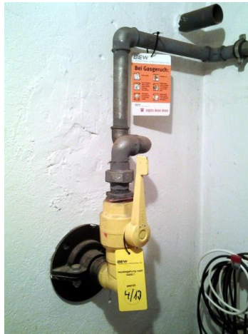
Axialausgleich mit Stahlrohr jedoch ohne Strömungswächter
