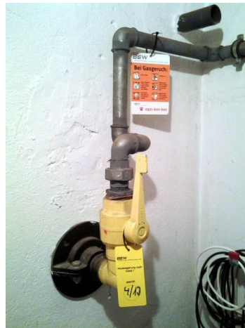
Axialausgleich mit Stahlrohr jedoch ohne Strömungswächter
